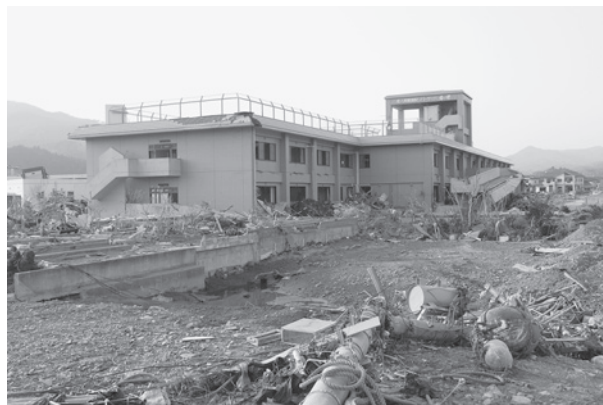
図2 被災した老人保健施設。津波が2階部分をも埋め、多くの入居者が犠牲になった。
